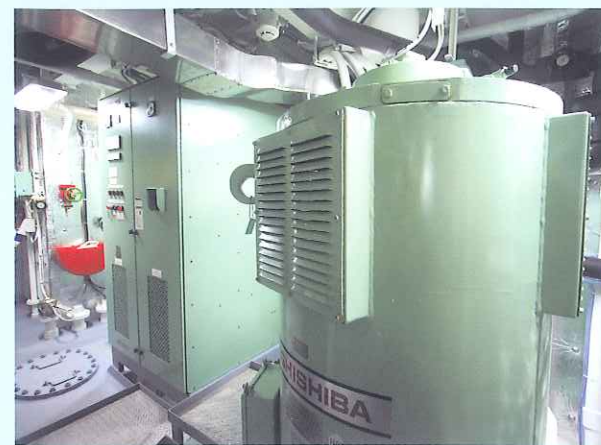
ポンプジェット室 / Pump jet room
