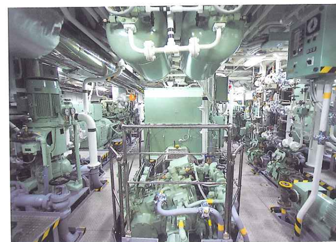
機関室 / Engine room
